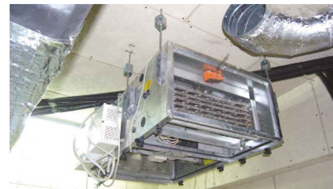
Виброизоляция подвешенного фанкойла Виброизоляторы: Vibrofix Box Объект: телекомпания "Новый канал", Киев
